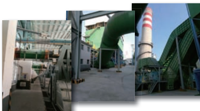
乾法氟化鹽回收設施
