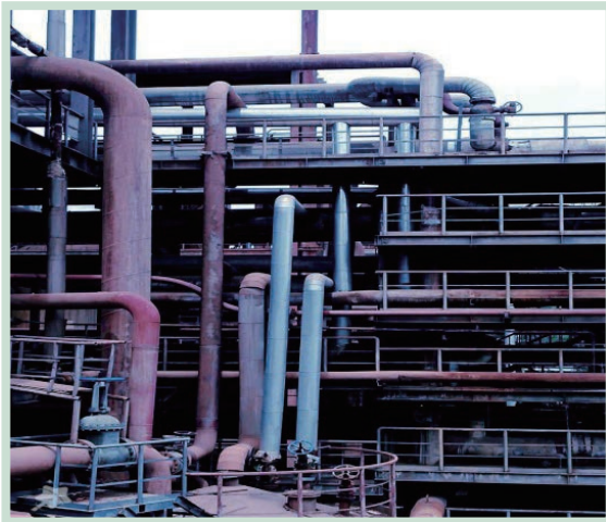
利用稀釋罐及稀釋槽作加熱工序
